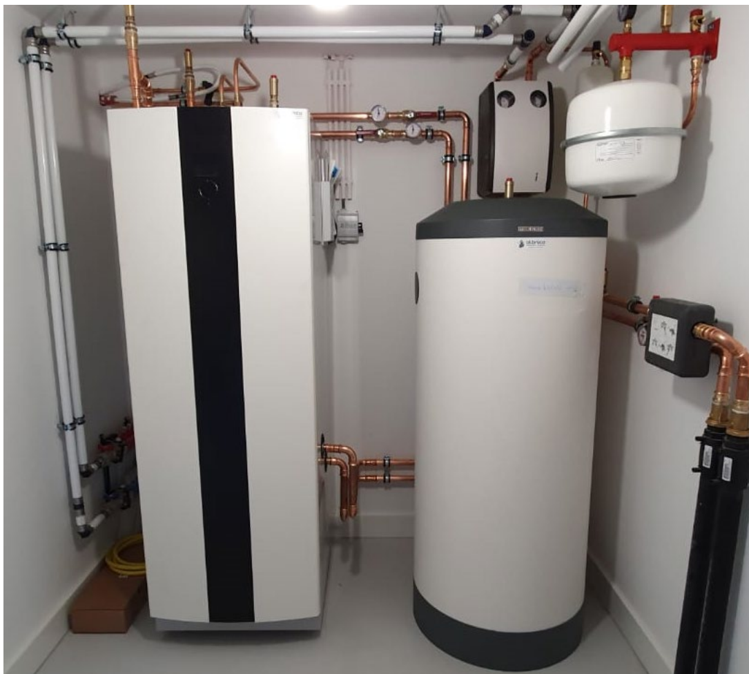
Figuur 32: Opstelling bodem warmtepomp met geïntegreerde boiler en buffervat. (Bron: Albreco)
