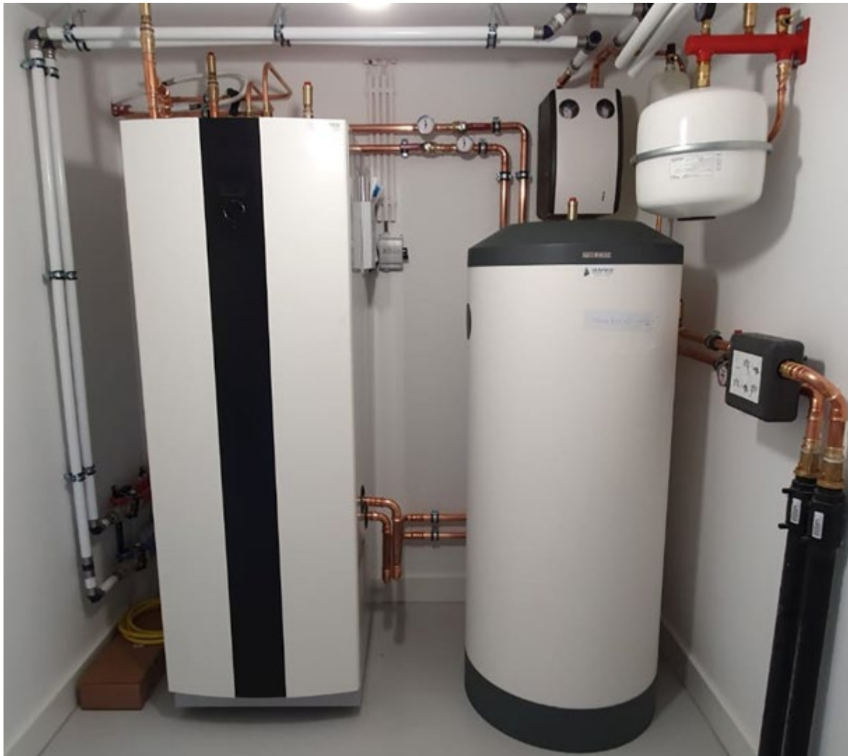
Figuur 38: Opstelling warmtepomp met geïntegreerde boiler en buffervat. (Bron: Albreco)
