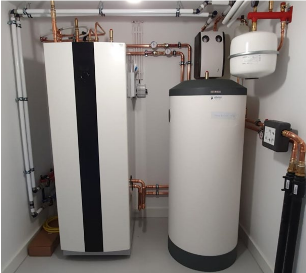
Figuur 29: Opstelling warmtepomp met geïntegreerde boiler en buffervat. (Bron: Albreco)
